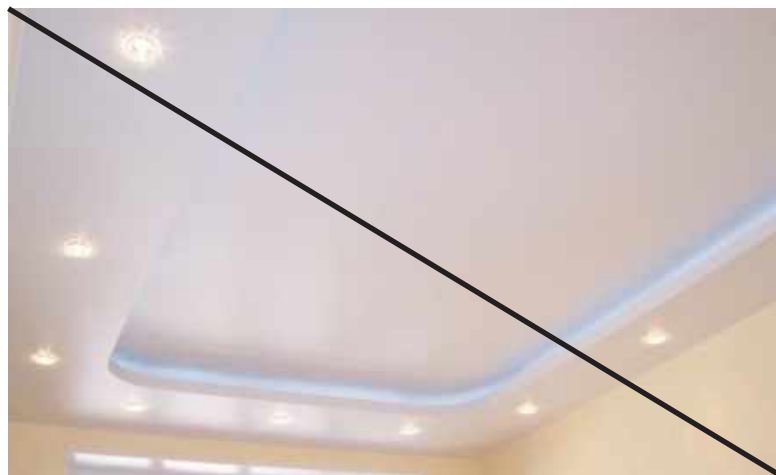
Плохо Многоуровневые гипсокартонные конструкции
