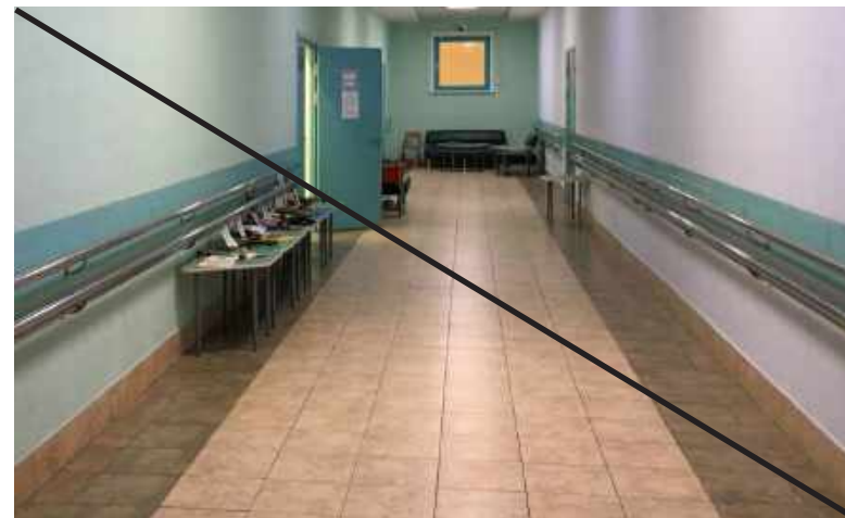
Плохо Керамогранитная плитка с крупными швами
